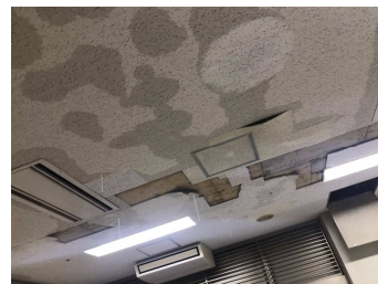
給湯管の老朽化による漏水が発生してしまった状況です。
